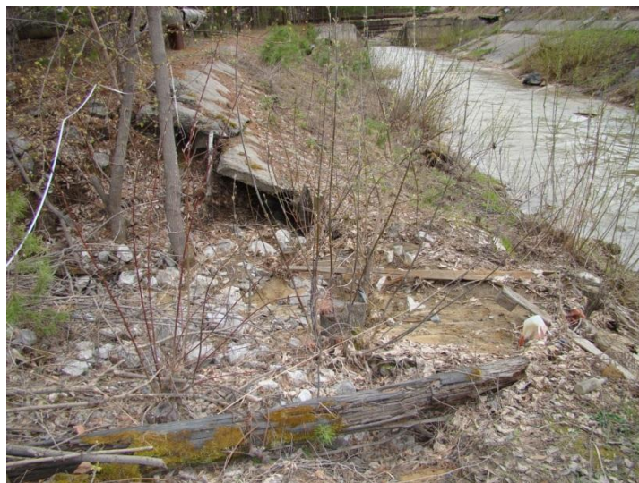
Рис 4. Разрушение железобетонной облицовки канала
