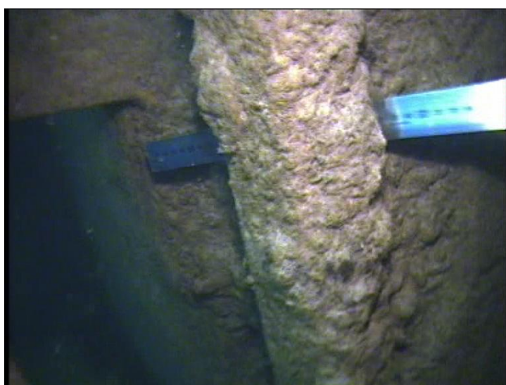
Рис. 3. Разрушение железобетонных конструкций под водой
