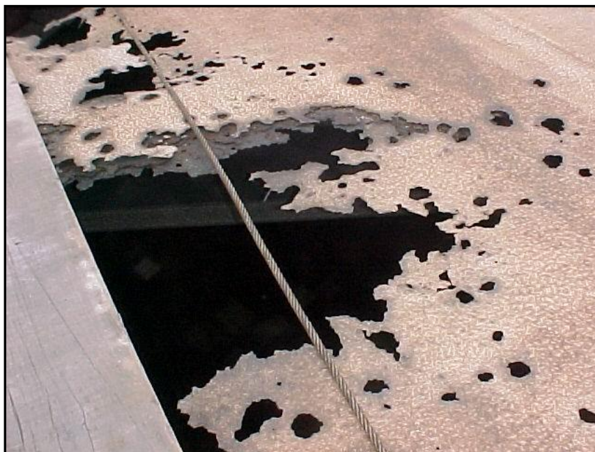
Рисунок 1 Примеры коррозии резервуаров [3]:
