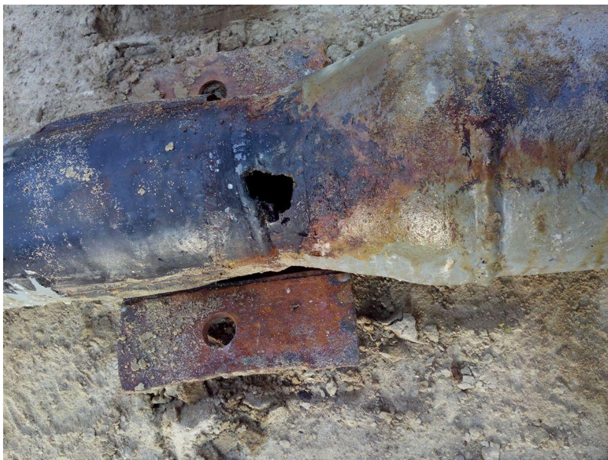
Рисунок 4.1 - Ручейковая коррозия вид изнутри и снаружи, очаговая коррозия вид снаружи
