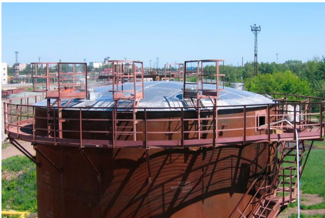
Рис.11- Резервуар РВС со стационарной крышей
