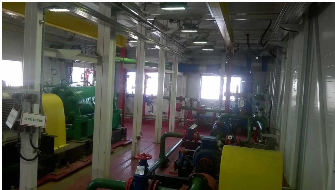
Рисунок 1.2 – Вид БКНС внутри
