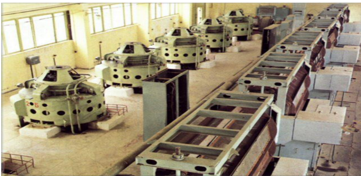
Рисунок 1.3 – Машзал береговой насосной станции
