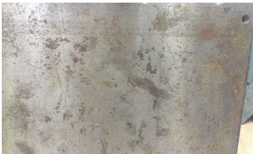
Рисунок 2.1 – Металлическое изделие, подвергшееся коррозии
