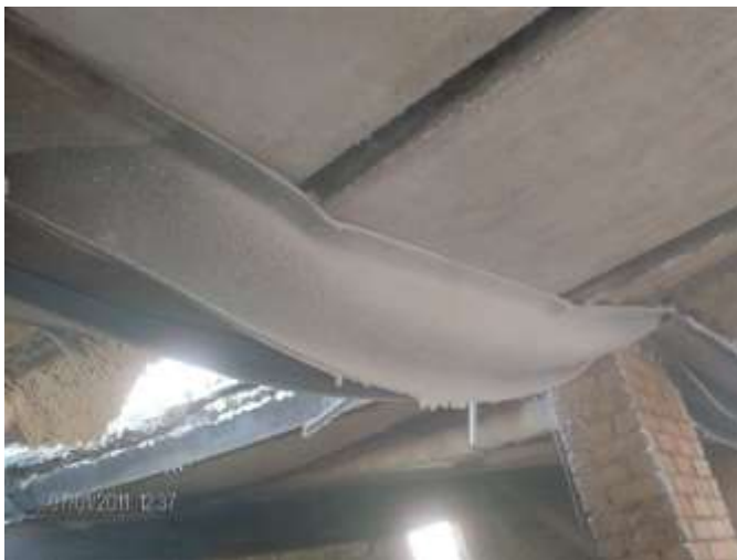
Рисунок 4.2. – Деформированная несущая двутавровая балка
