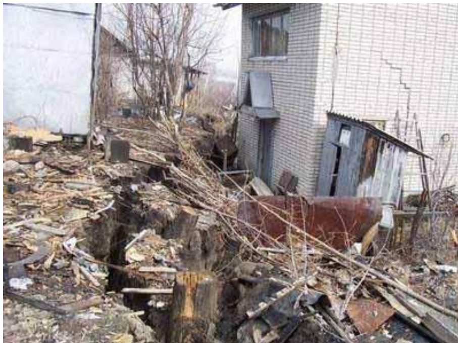
Рис. 1.7. Оползень по ул. Канская 19.04.2006 г. [69].
