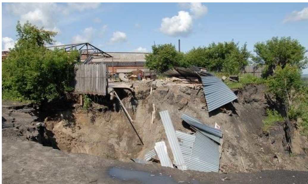
Рис. 1.8. Оползень по ул. Фабричной 01.07.2011 г. [69].
