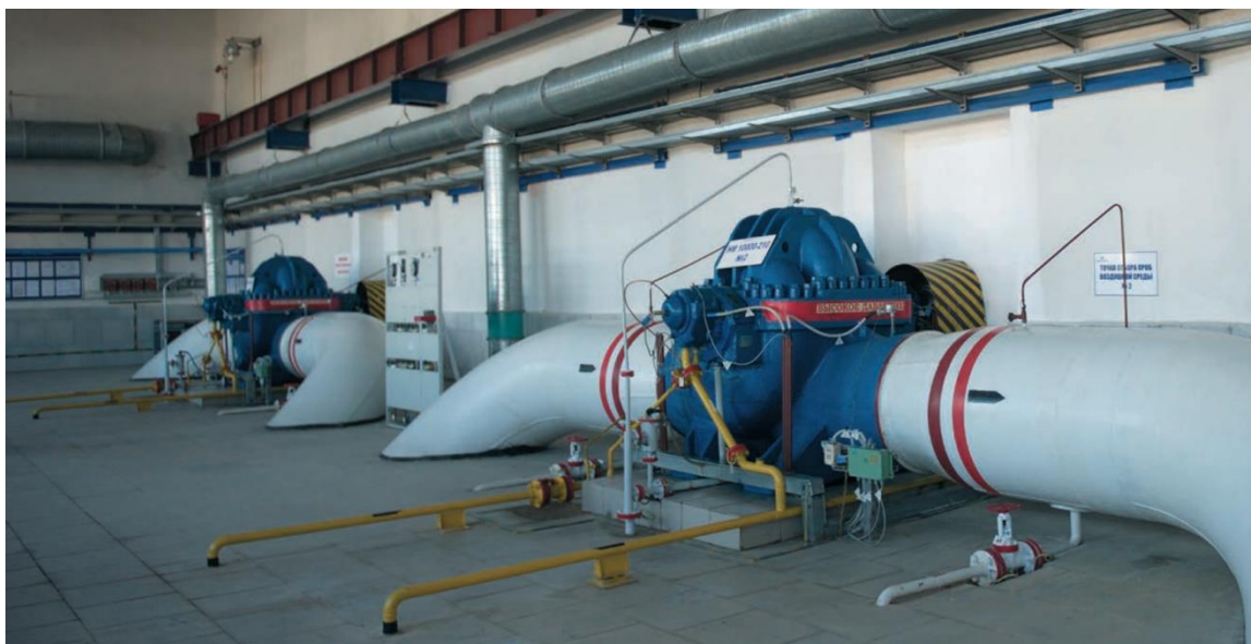
Рис. 1.2. Насосный зал с разделительной стеной
