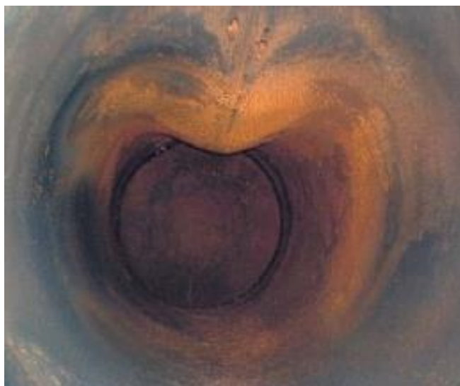
Рисунок 1 – Отдулина топки жаротрубного котла
