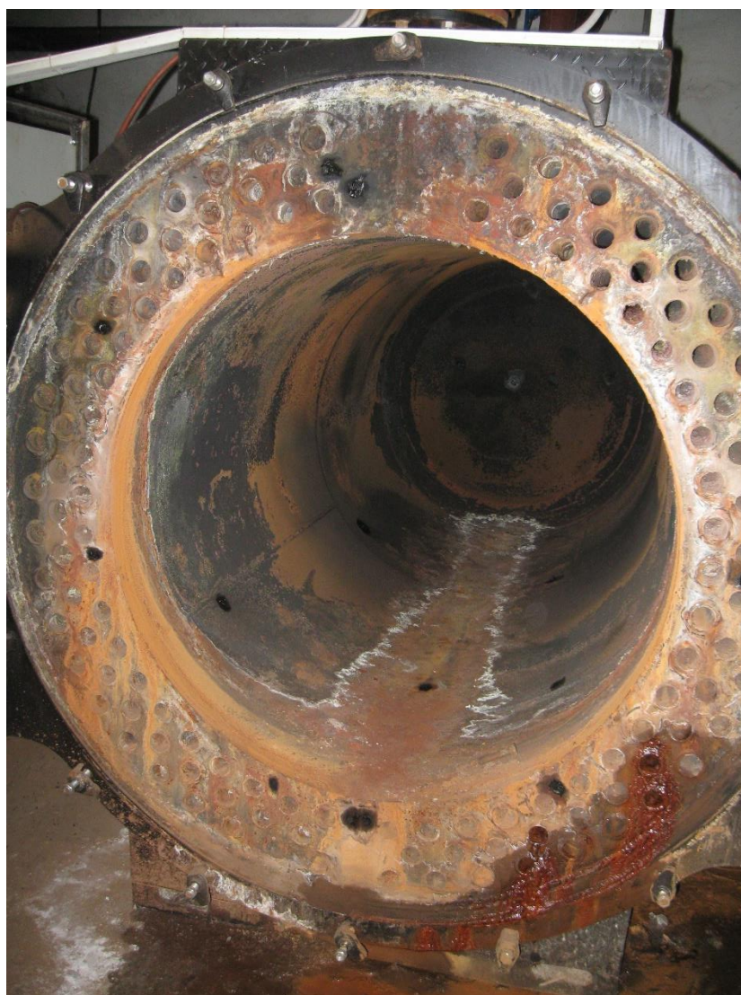
Рисунок 2 – Разрыв сварного шва и подтеки в результате попадания теплоносителя в газовый объем
