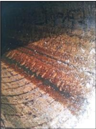
Рисунок 12 – Вид внутренней поверхности нефтепровода перед очисткой
