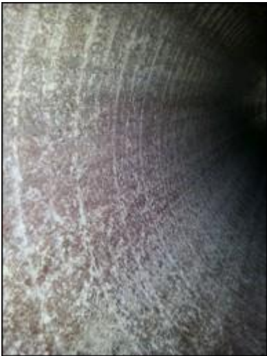
Рисунок 13 – Вид внутренней поверхности нефтепровода после очистки
