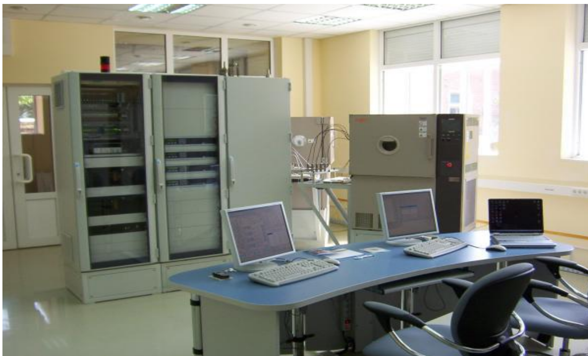
Рисунок 7 - Автоматизированная система калибровки датчиков давления Операции, подлежащие выполнению на оборудовании, и уровень их механизации
