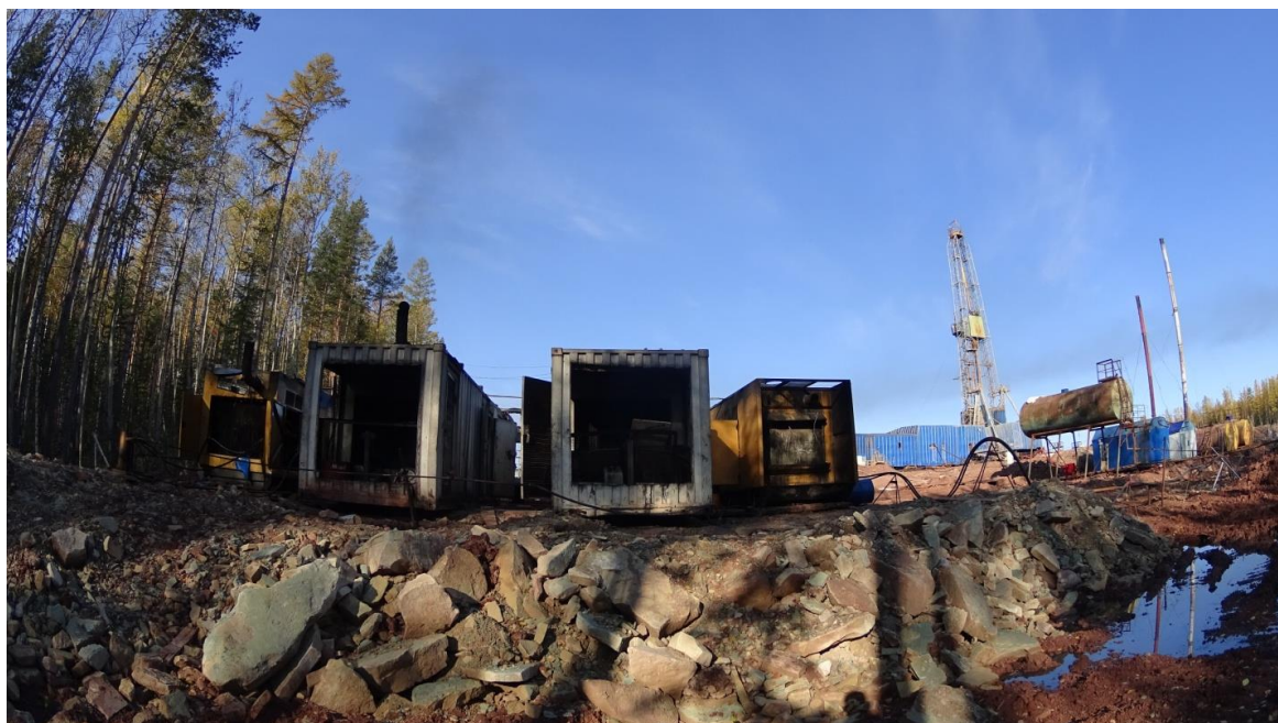
Рисунок 7 -. Дизельные генераторные установки Caterpillar CAT 3408 DITA
