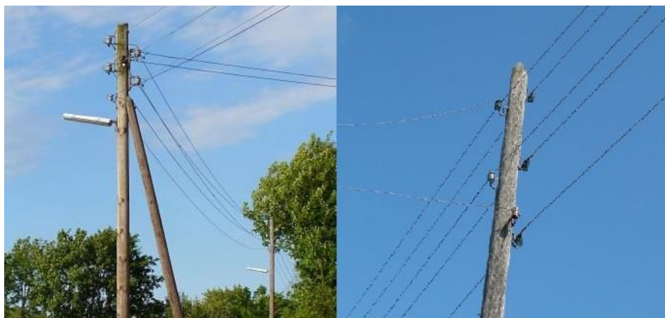
Рисунок 1.1 – Линия ВЛ 0,4 кВ до реконструкции
