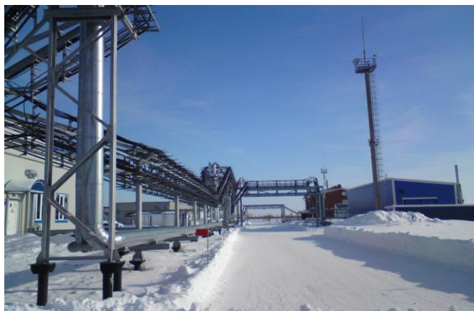
Рисунок 1 – Нефтеперекачивающая станция Парабель
