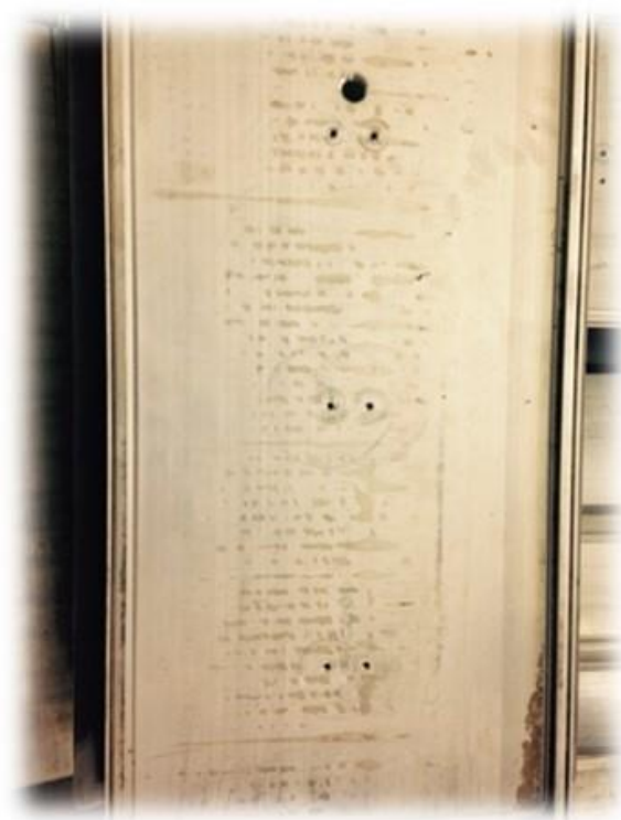
Рисунок 10 – Корпус после хранения на улице
