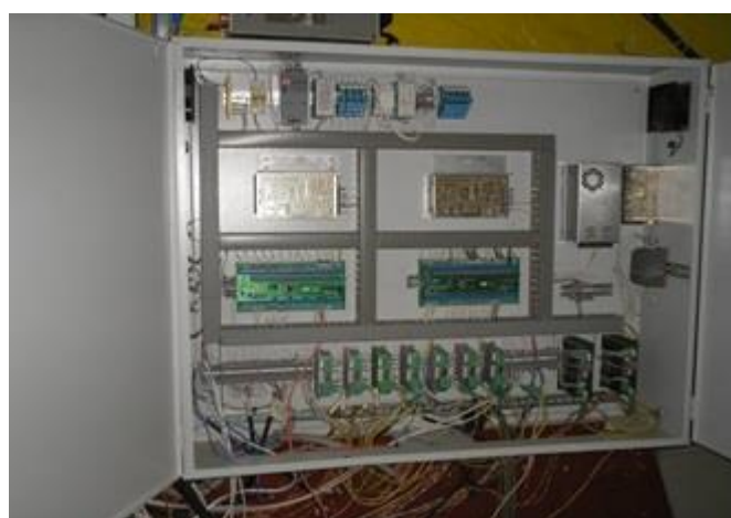
Рис. 4.14. Шкаф управления легированием кремния
