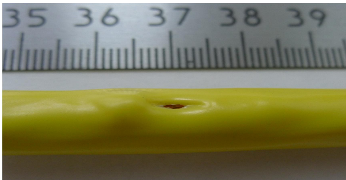
Рисунок 1.2.5 – Местные разрывы и шишки по изоляции
