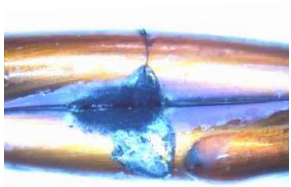
Рисунок 8 – Характерный вид места пробоя изоляции макетного образца в месте дефекта.
