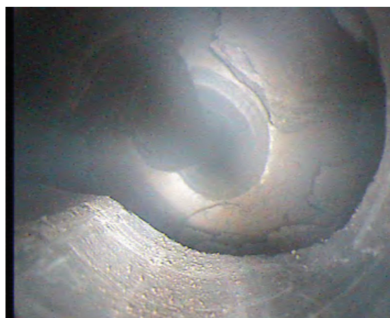
Рис. 3. Обрушение породы. Каверна
