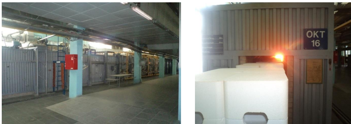
Рисунок 5.4 – Газовая печь туннельного типа Wistra 3
