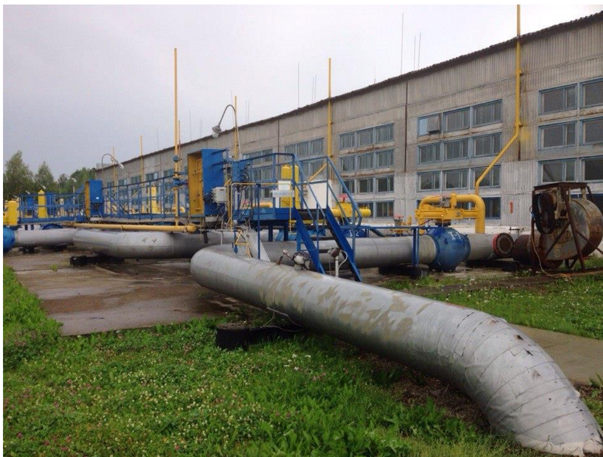
Рис 1.1 – Компрессорная станция «Александровская»
