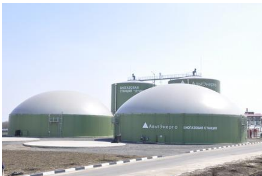
Рисунок 5 – Биогазовая установка ООО «АльтЭнерго»
