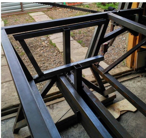
Рисунок 4.1 – Внешний вид толкателя, установленного в приемном бункере
