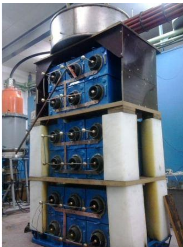
Рисунок 7. Внешний вид конденсаторной батареи.
