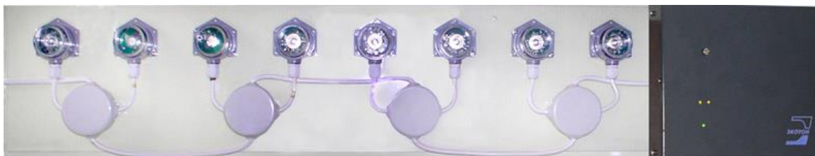
Рисунок 4- «Экотон - 12» си система аварийного освещения
