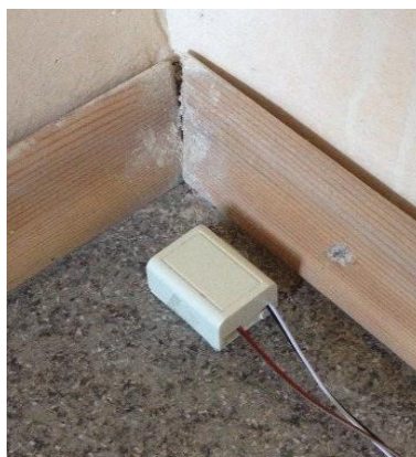
Рисунок 4.20 – Акселерометр на полу читального зала III этажа
