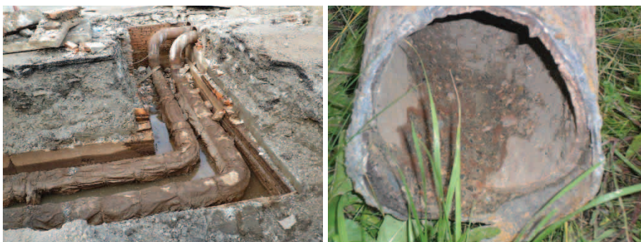
Рис. 9. Внутренняя коррозия трубопроводов тепловых сетей
