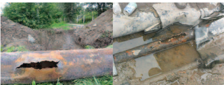
Рис. 10. Внешняя коррозия трубопроводов тепловых сетей
