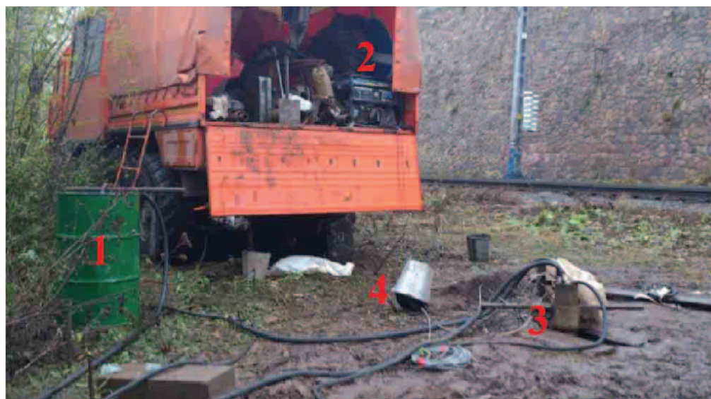
Рис. 6. Площадка проведения откачки из скважины 56: 1 – мерная емкость; 2 – генератор электроэнергии; 3 – скважина; 4 – электроуровнемер (с защитой от дождя)
