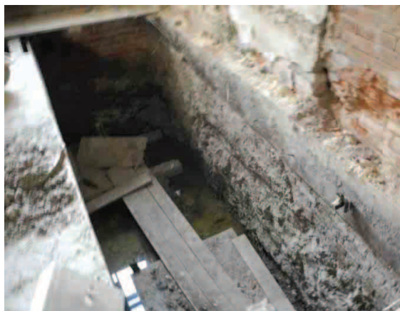
Рис. 1. Вода в подвале здания вокзала
