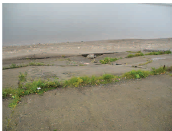
Рис. 4. Проседание и деформация плит в результате суффозионных процессов
