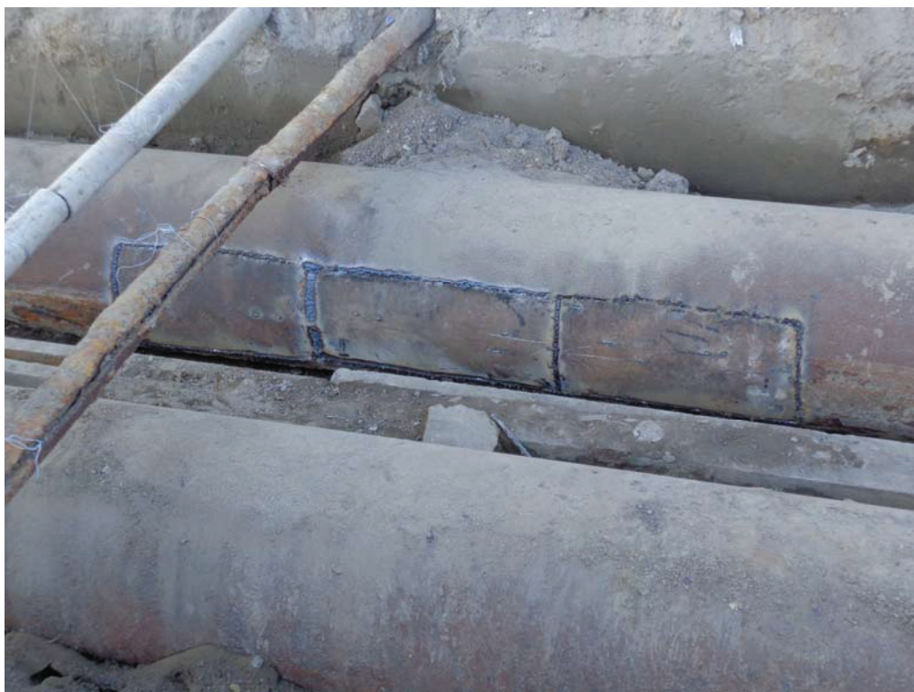
Рис. 2. Место интенсивной коррозии вблизи точки пересечения с электрическим кабелем
