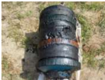
Рисунок 6 – Трубопровод не готов к пропуску диагностических снарядов. Требуется дополнительная чистка трубопровода.
