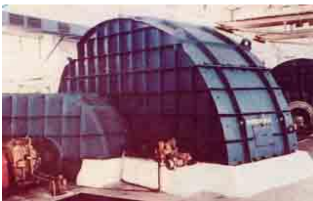
Рисунок 1 – Вентилятор главного проветривания ВОД30М2
