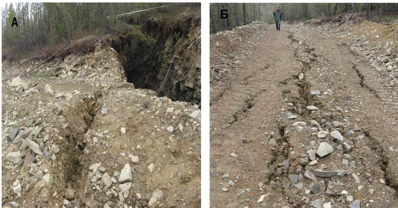
Рис. 3.2.7 Распространение процессов трещинообразования вдоль притрассовой дороги около моста через р. Дурай. А – образование крупной канавы, секущей дорогу, Б – активное развитие системы трещин на полотне дороги (точка 2 на рис. 3.2.6).
