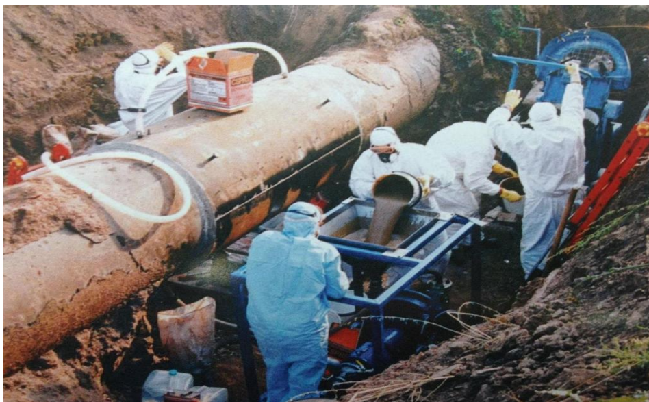
Рисунок 5 – Аварийный участок АРН на межпромысловом трубопроводе
