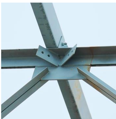
Рисунок 26 Места креплений на верхнем поясе металлических конструкций перекрытия для установки поперечных регулируемых связевых тяжей.
