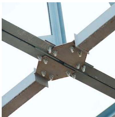
Рисунок 25 Нижнее болтовое соединение металлоконструкций перекрытия с дополнительными связями, фиксирующими их горизонтальное смещение.
