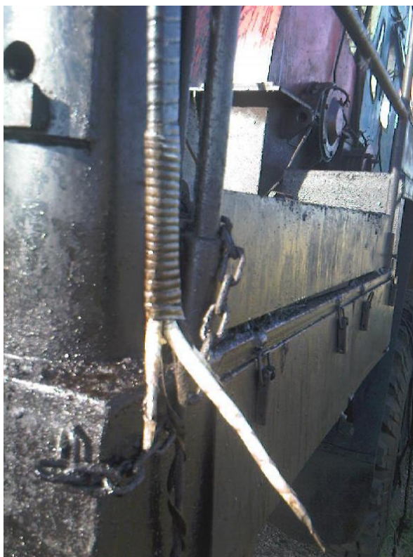
Рисунок 1.5. Обрыв кабеля на скважине
