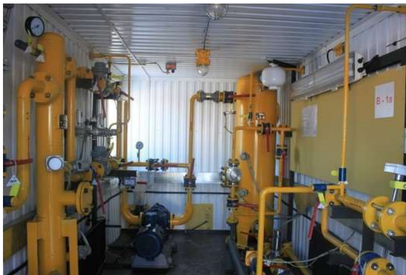
Рисунок 1 – Установка комплексной подготовки газа
