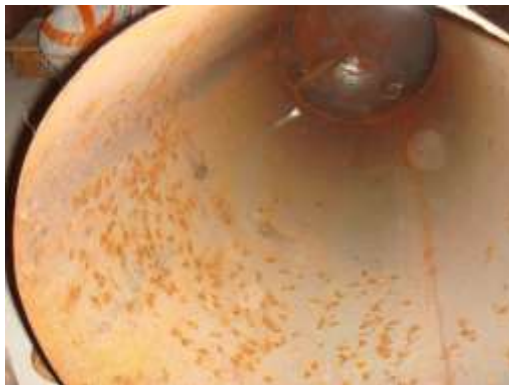
Рисунок 10.1 – Пример коррозии емкости хранения одоранта
