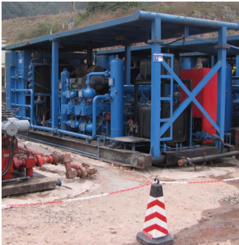
Рисунок 20 – Дожимной компрессор HURRICANE B15-62/2175 во время эксперимента на Куюмбинском месторождении
