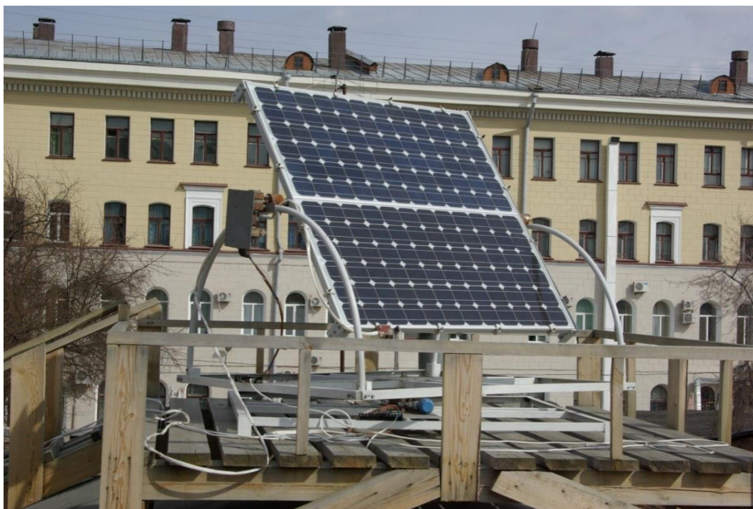
Рисунок 4.2 – Электромеханическая часть энергетической установки АФЭУ-0,5 с двумя фотоэлектрическими панелями КСМ-160
