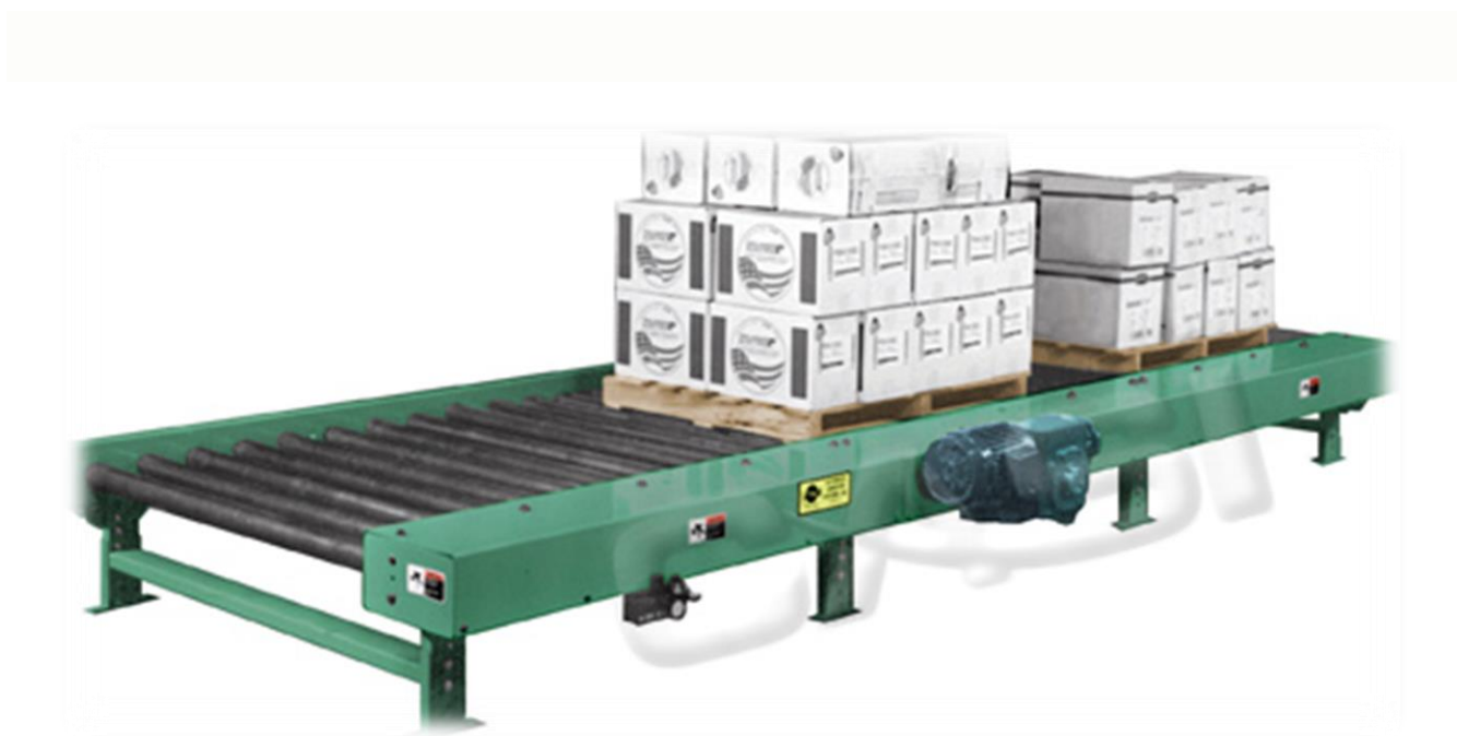
Рисунок 1.8 – Транспортировка поддонов по конвейерной ленте
