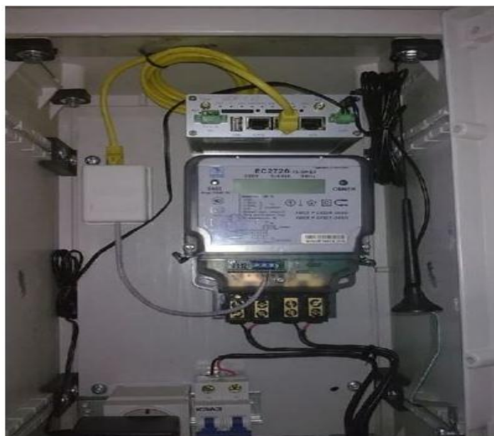
Рисунок 10 - автоматизированный счётчик электроэнергии типа: EC2726
