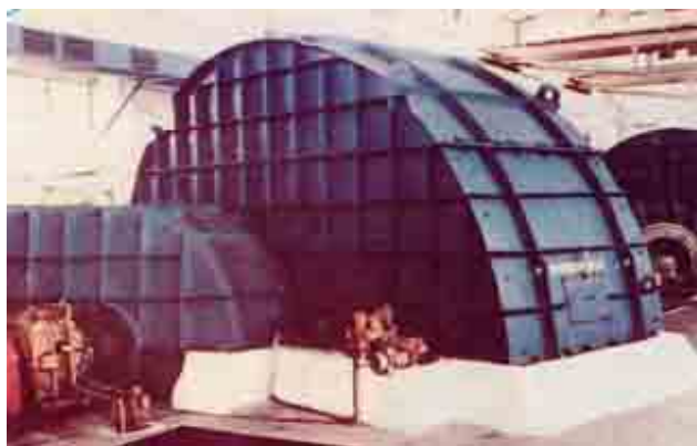
Рисунок 1 – Вентилятор главного проветривания ВОД30М2
