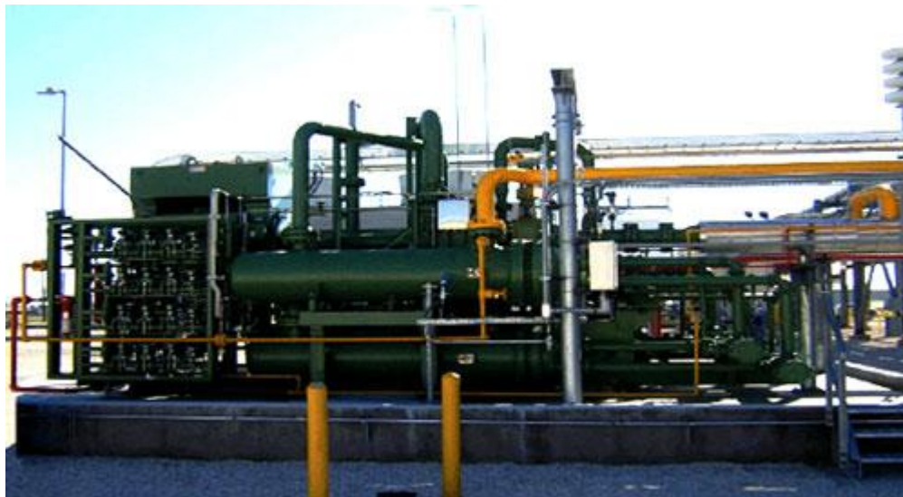
Рис. 1 – Общий вид дожимной компрессорной станции
