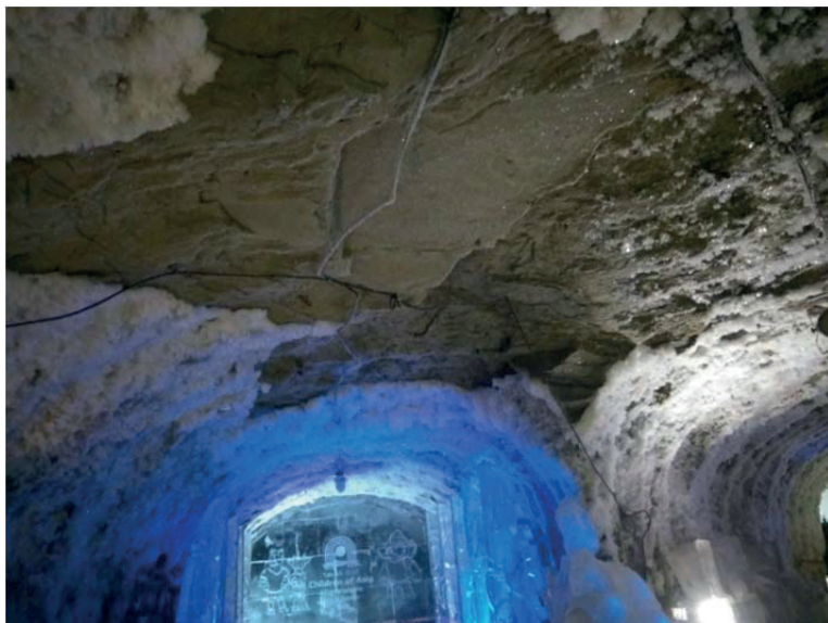
Рис. 2. Вывал пород кровли в районе сопряжения штольни 1 и камеры 4 ЦВМ
