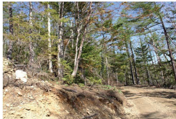
Рис. 4. Оползни гидродинамического разрушения
