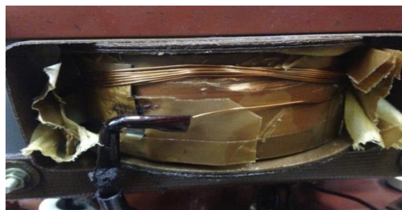
Рис. 1. Дефект обмотки ВН – аксиальное смещение обмотки
