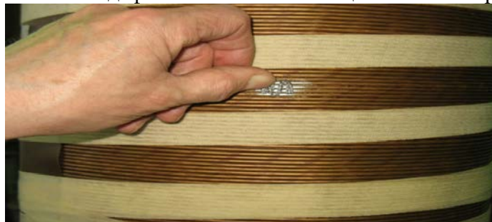
Рис. 3. Вид дефекта витковой изоляции обмотки силового трансформатора.
