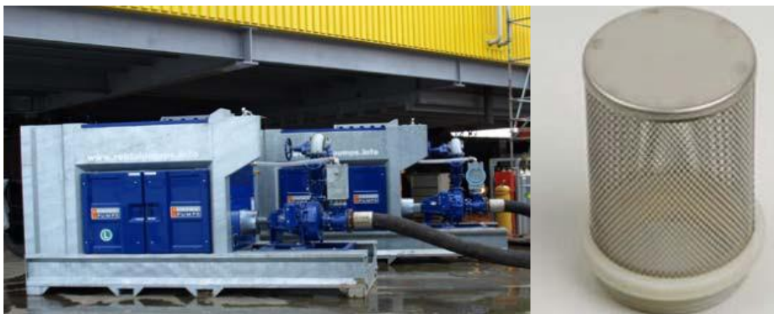
Рисунок 1.25 - Насосное оборудование и защитные устройства для забора воды на гидроиспытания
